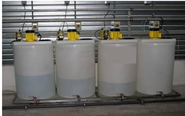
dosage de minéraux pour l'eau potable
